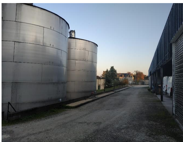
Photo n° 3 : Les cuves N et M (5500 hl)
